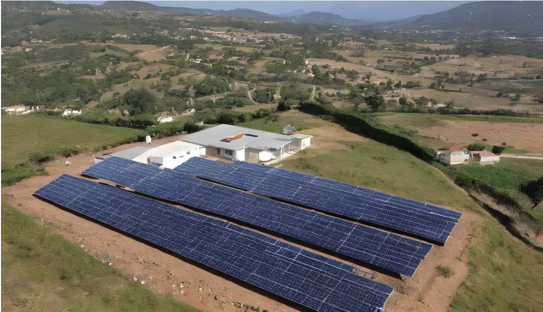
Figura 1. Prompt: Instalación fotovoltaica. Fuente: https://wepik.com/my-creations
